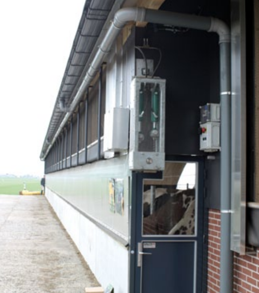
Stand van de klep in de feedwall is aan te passen middels een hydraulisch systeem.
